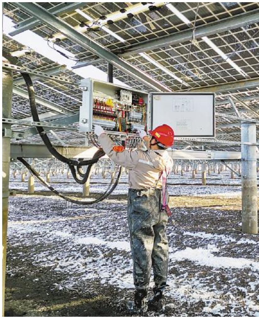
通威和县“渔光一体”项目运维人员开展雪后巡检
